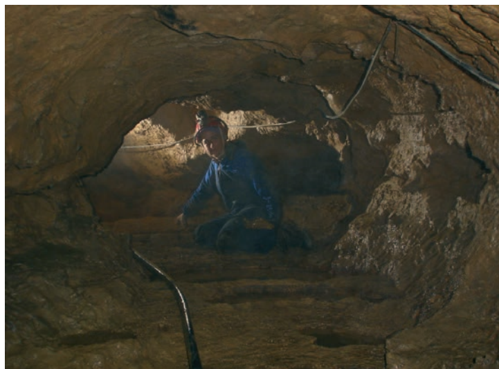
Vista de la instal·lació de la mànega i el cable elèctric.
